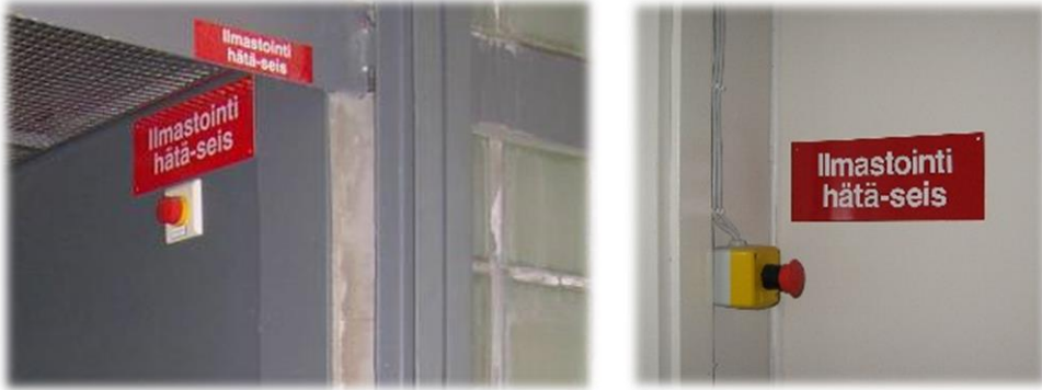
Kuva 54. Porrashuoneessa sijaitseva ilmanvaihdon hätäpysäytyspainike (Pelastusopisto).
