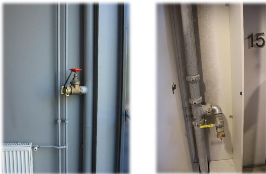
Kuva 65. Kuvissa on nousujohtojen ulosottoja kerroksessa (Latvala).
