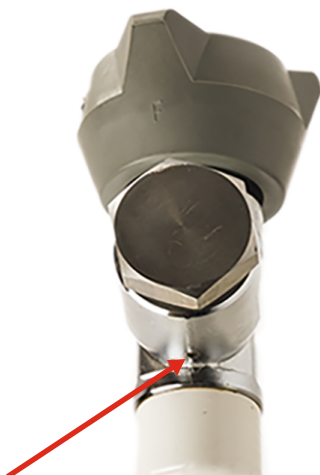
Kuva 40. Paineilmasäiliön venttiilin paineen purkaukko.
