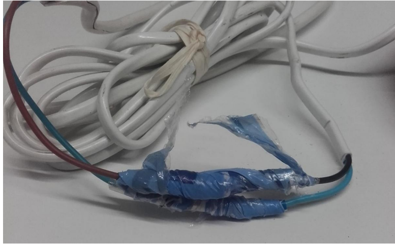
Kuva 4. Keittolevyn johtimien liitokset oli eristetty muovipussilla. (Kuva Pirkanmaan pelastuslaitos)
