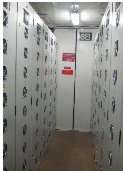
Kuva 11. Energiavaraston akkuhuoneen akkuräkit
